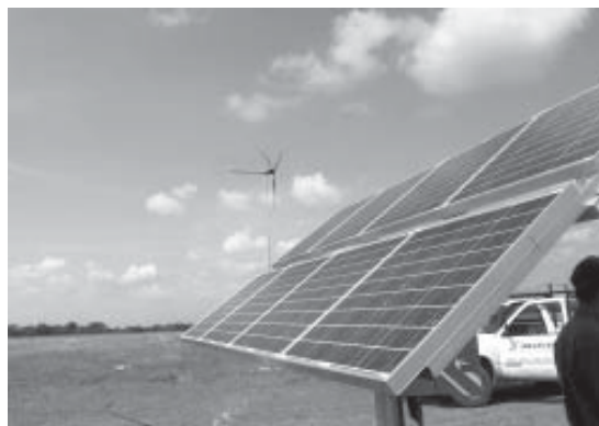
Foto: Sistema híbrido eólico-solar con el aerogenerador Whisper al fondo.
